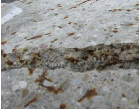
Duidelijke corrosie bij de staalvezels (zoutoplossing)
